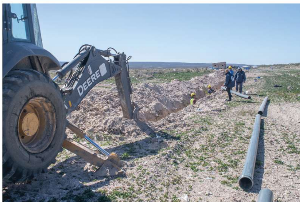
Red interior de Agua en Parque industrial II
